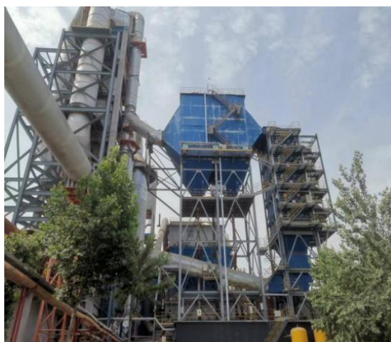
窑尾收尘器+SNCR+SCR 脱硝系统
