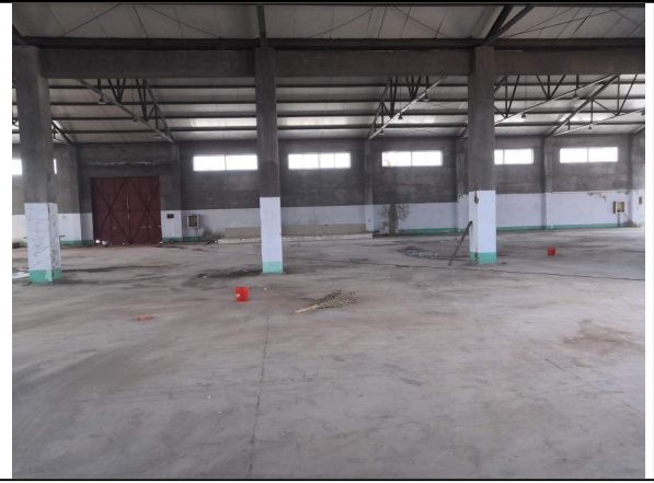
项目车间内景
