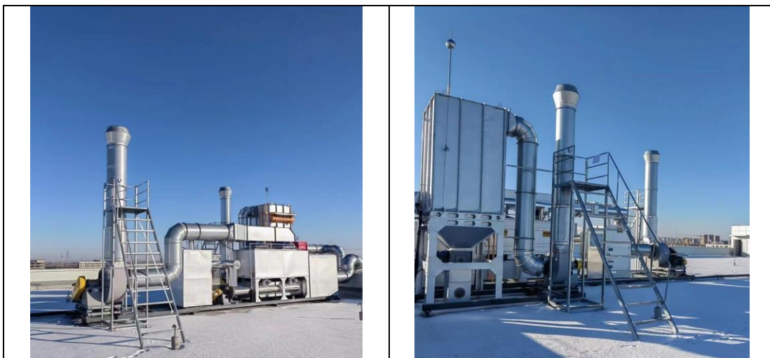
依托布袋除尘器设施现场照片
