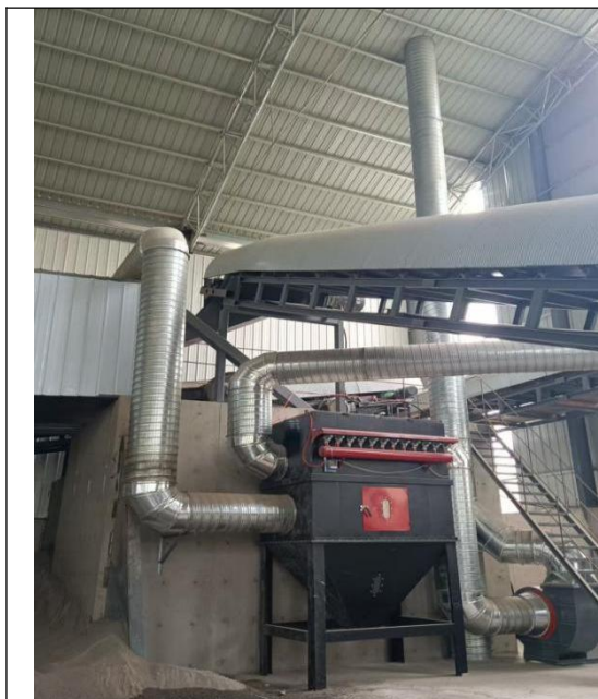
除尘器+排气筒
