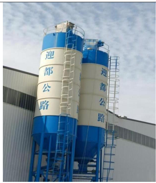
水泥仓+仓顶除尘
